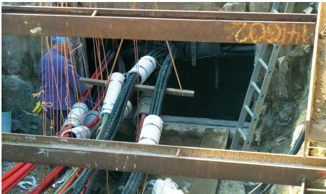
Rond de aangelegde kabels en beschermbuizen werd een uitsparing gemaakt en rond elk kabelsysteem werd een gesplitste doorvoerbuis gemonteerd.
