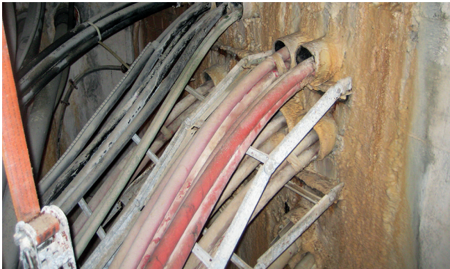
Toestand van de duiker voor de sanering: er drong water binnen tussen de beschermbuizen en de kabels en tussen de beschermbuizen en de wand.
